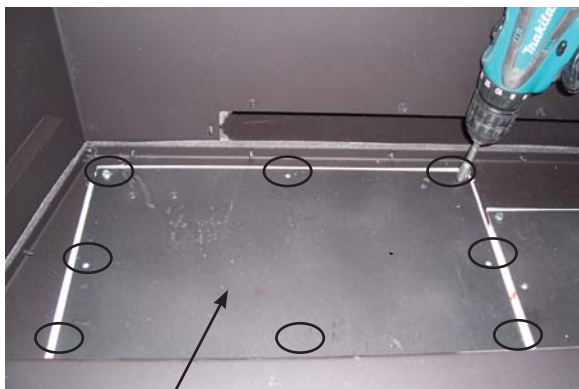
Fan Access Panel
